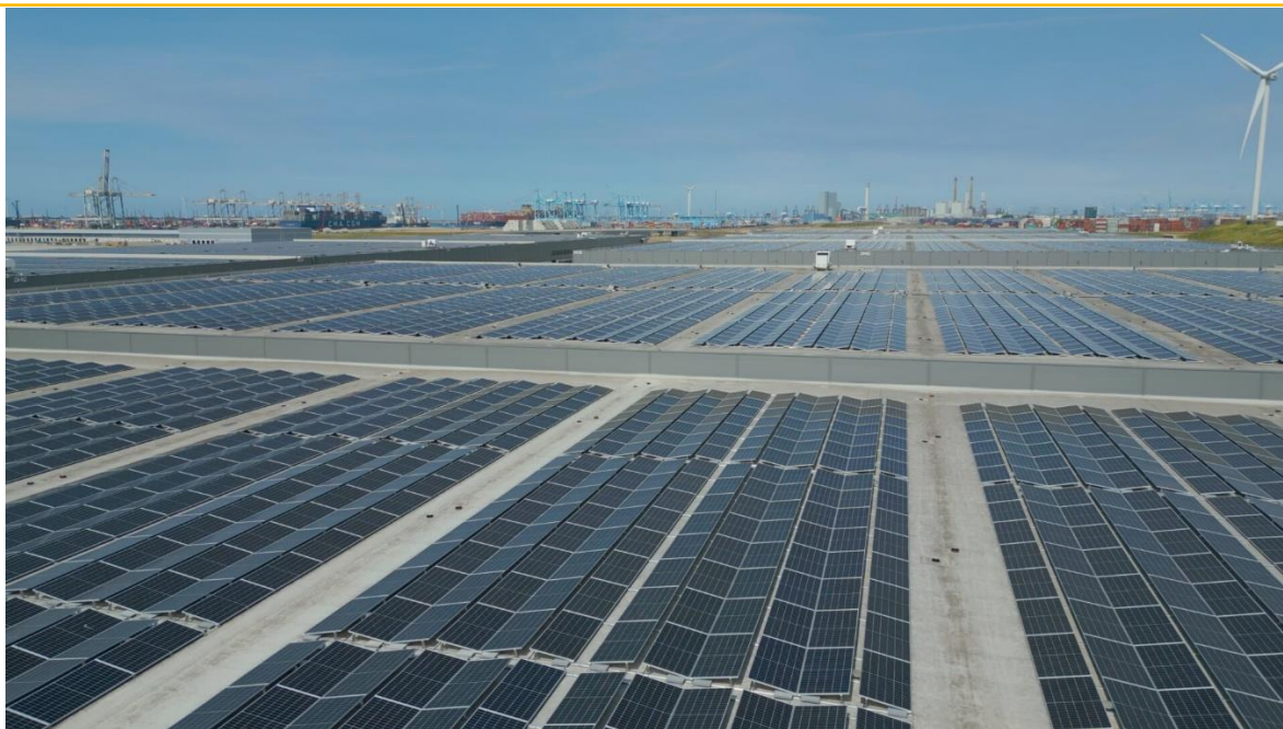
GOLDBECK SOLAR Maasvlakte Solardach
